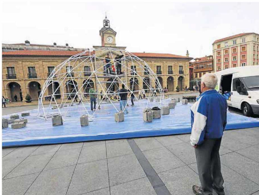
Los operarios trabajaron ayer para montar la cúpula que albergará las proyecciones. :: MARIETA
